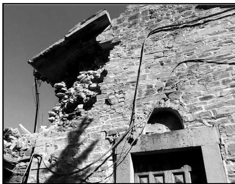
Dopo il terremoto
